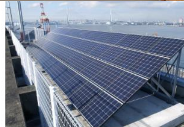
太陽光発電パネル (24.5KW)
