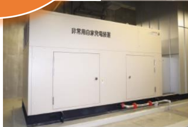
ガスタービン発電機 (500KVA)
