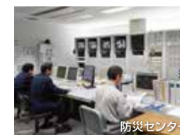
防災センター
