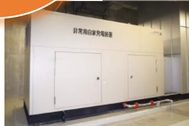
ガスタービン発電機 (500KVA)
