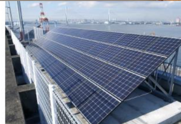
太陽光発電パネル (24.5KW)
