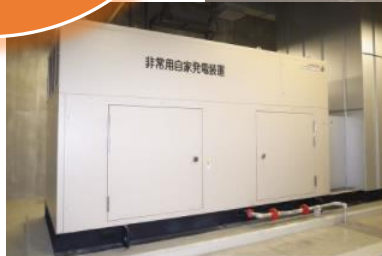
ガスタービン発電機 (500KVA)
