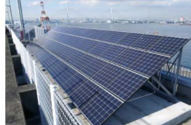
太陽光発電パネル (24.5KW)
