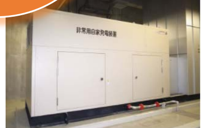
ガスタービン発電機 (500KVA)
